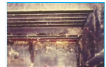
Nach der Systemreinigung – die Folgen eines mikrobiologischen Befalls (Korrosion durch Mikroorganismen) sind deutlich sichtbar
